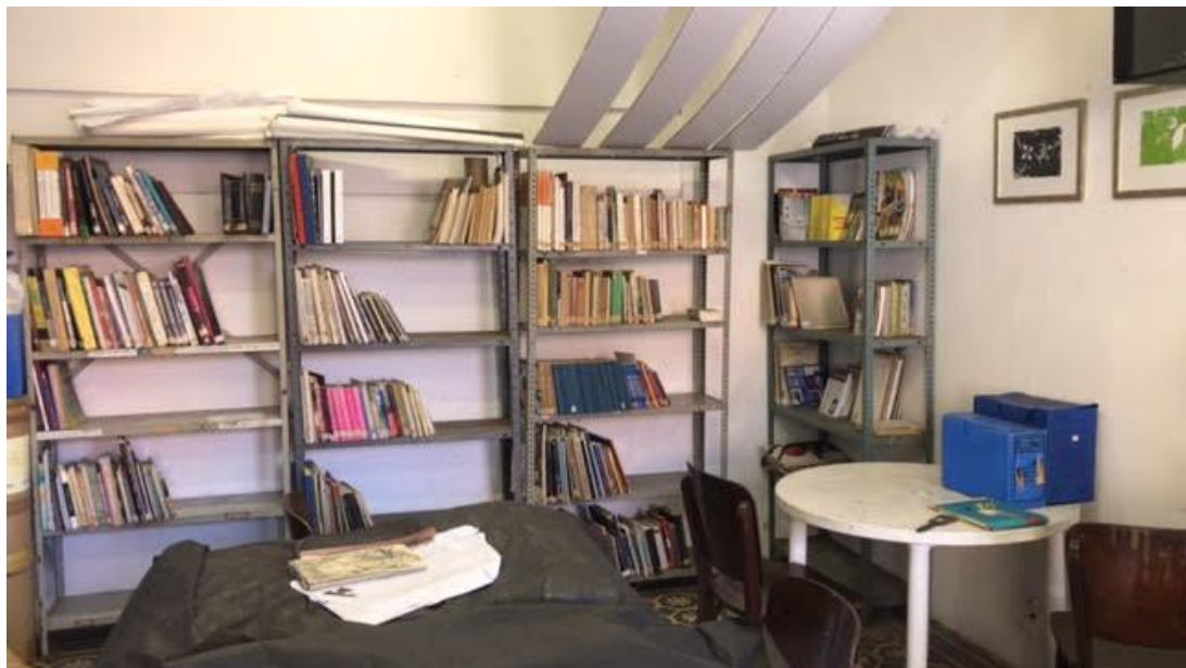
Imagem III: Situação do teto em uma das salas até o mês de outubro 2021
