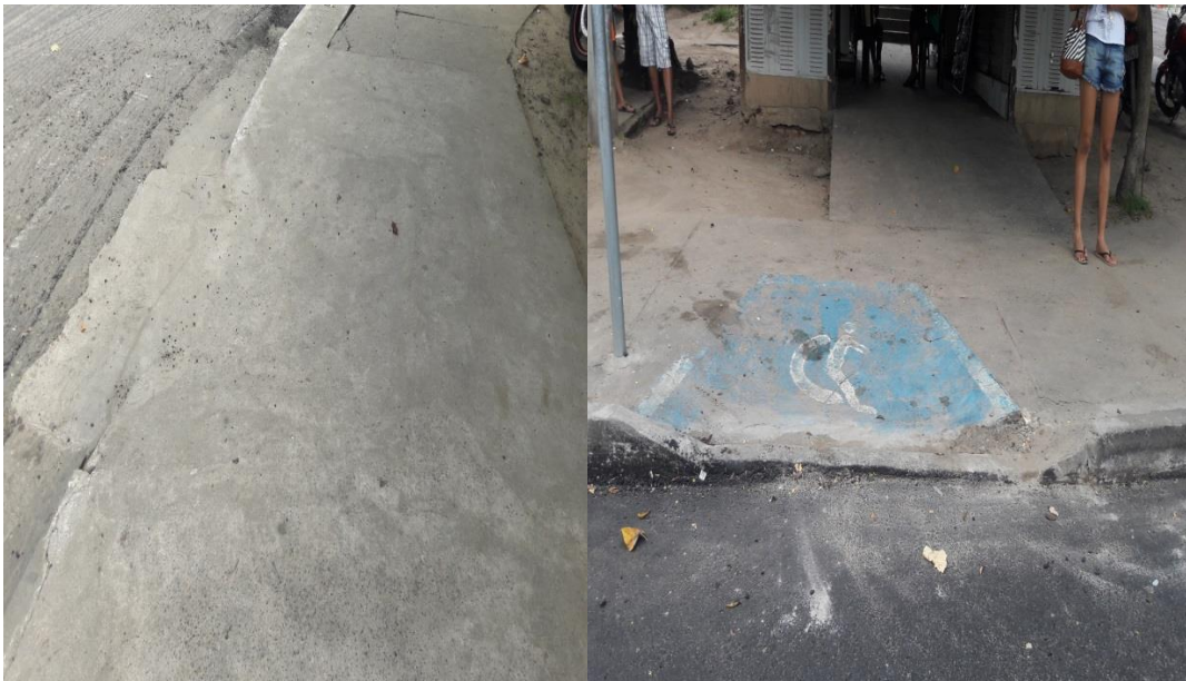
Figura 5. Sinalização inexistente ou precária -Foto realizada em 06/05/2015. (captura de Marcio Alexandre Gomes)
