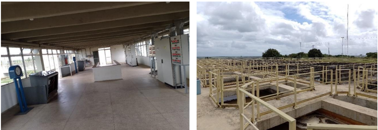
Figura 18: Fotografias realizadas em visita técnica – Instalações da ETA Gramame, Paraíba
